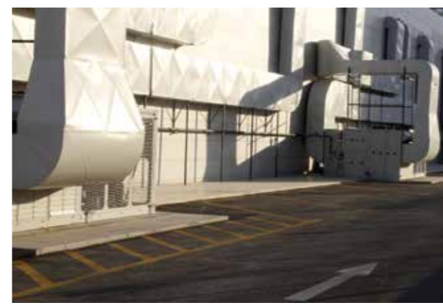
Rysunek 15: Przykładowa instalacja przy hali wystawowej ©Untes
