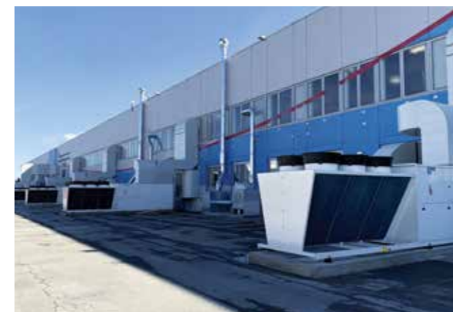
Rysunek 10: Przykładowa instalacja przemysłowego obiektu produkcyjnego ©Clivet
